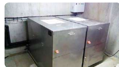
L’inauguration de la chaudière numérique de l’immeuble Albert Londres du parc de Nantes Métropole Habitat, dans les quartiers Nord de Nantes a eu lieu en septembre.
